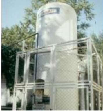
Resim 7.1: Merkezi sistem oksijen kaynağı
