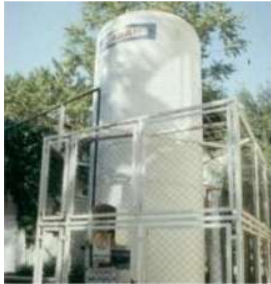
Resim 2.1: Merkezi sistem oksijen kaynağı
