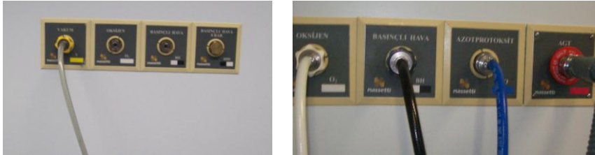
Resim 1.7: Anestezi cihazının merkezî sistem gaz kaynakları bağlantı panosu
