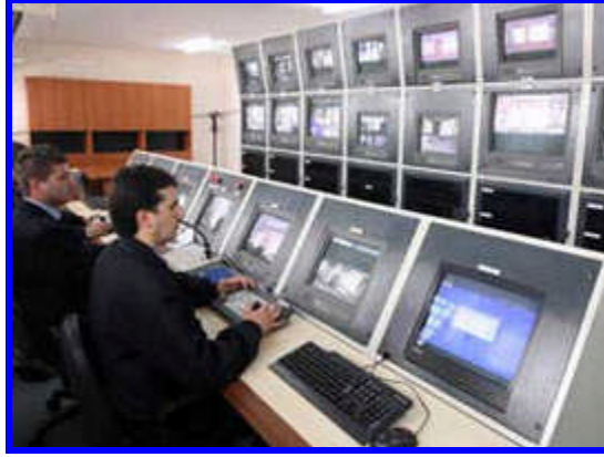
Resim 3.1: Ceza infaz kurumlarında merkez kontrol odası
