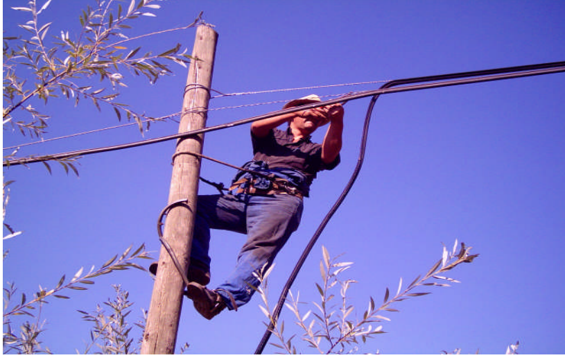
Resim 3.1: Arızalı kablo deęiřimi
