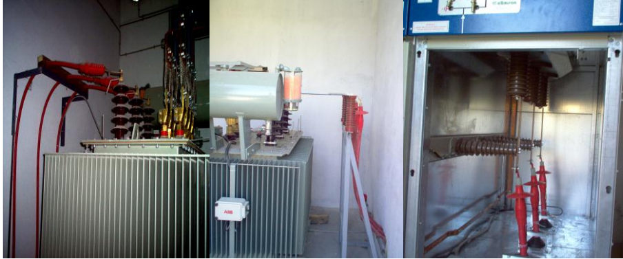
Resim 4.11: Dâhilî başlıklı kabloların trafo ve modüler hücrelere bağlantısı
