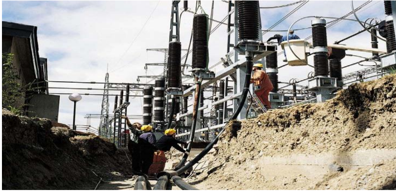
Resim 4.8: Şalt sahasında porselen başlığa yer altı kablo bağlantısı(240 KV)
