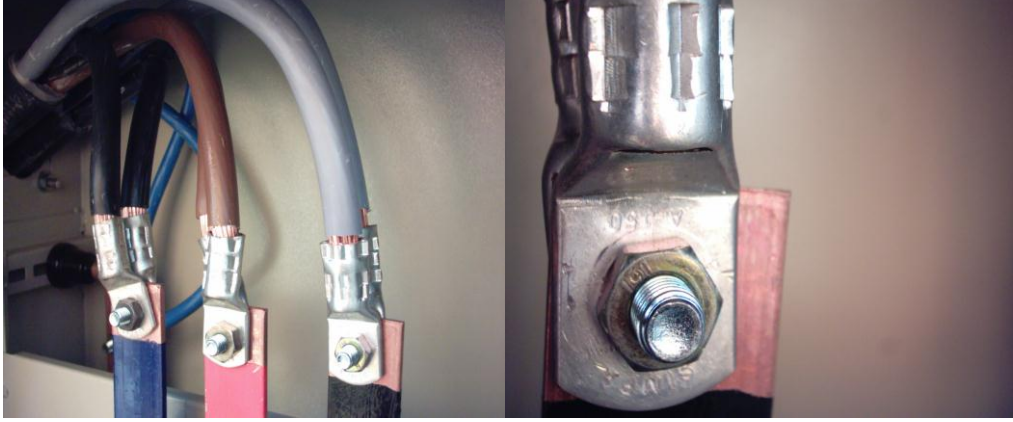
Resim 4.13: Yer altı kablolarının ana dağıtım pano baralarına bağlantısı
