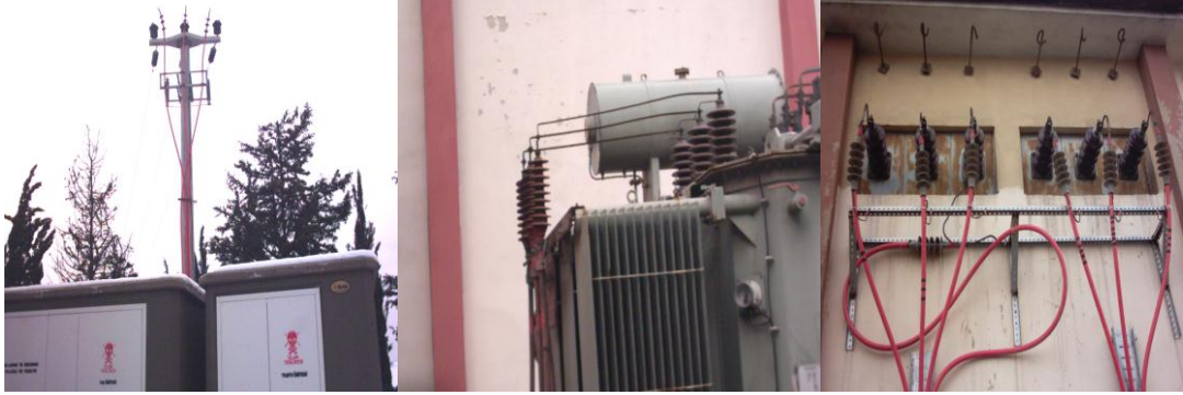
Resim 4.1: Yer altı kablo bağlantı yerleri (Dağıtım trafo merkezleri)
