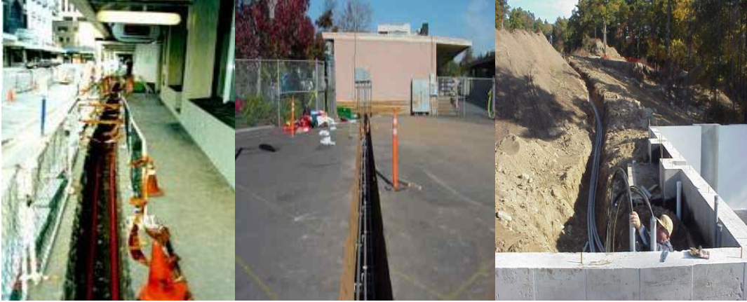
Resim 2.14: Kablonun değişik tipte kanallara dökmesi
