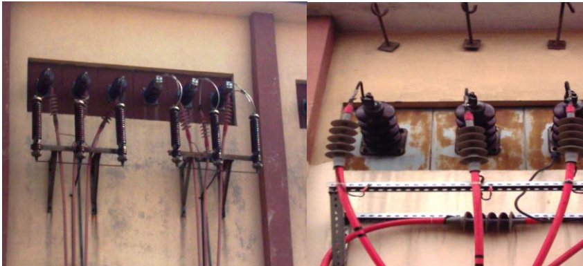
Resim 4.12:Trafo merkezine başlıklı kablo bağlantısı
