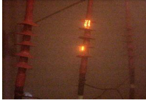
Resim 3.21: Kablo başlığında ark oluşumu
