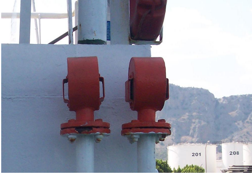
Resim 6.7: Balast tankları havalandırması
