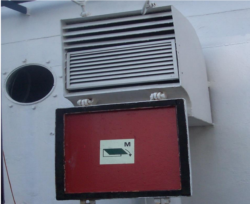
Resim 6.4: Makine dairesi dış havalandırma
