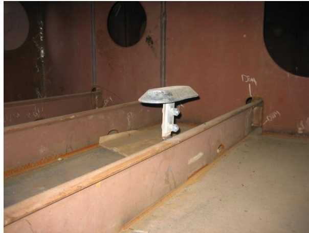
Resim 2.1: Balast tankının tutyta ile katodik korunması
