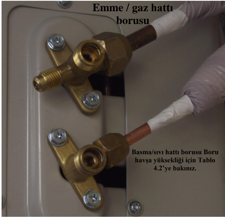
Resim 7.3: Soğutma modunda çalışan klimada boru hatları
