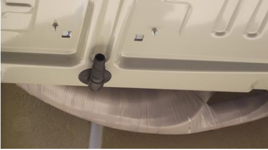
Resim3.9:Su tahliye piposunun dış üniteye bağlantısı
