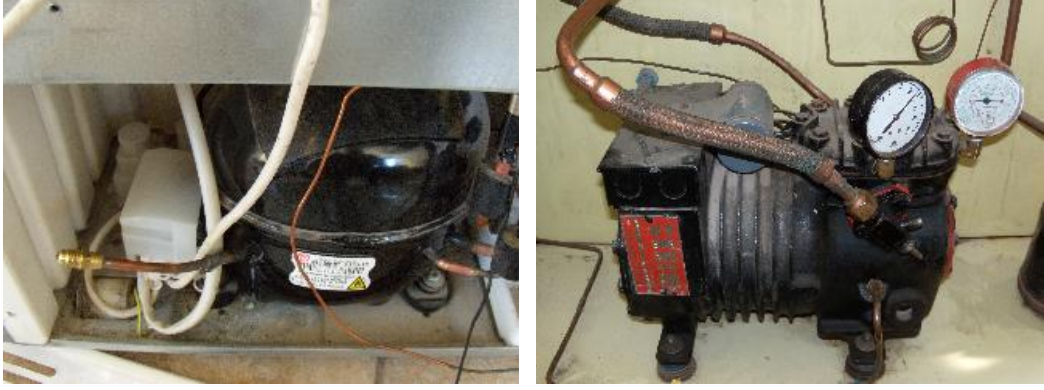
Resim 1.5: Kompresörlerin servis borusu ve servis valfleri
