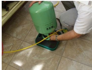
Resim 2.5. Soğutucu akışkan sıvı şarj durumu
