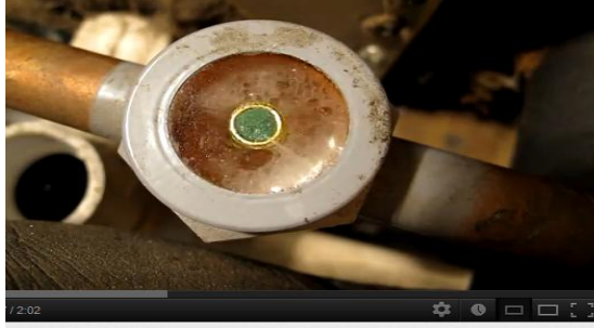
Resim 2.8: Şarj anında gözetleme camında kabarcık oluşumu
