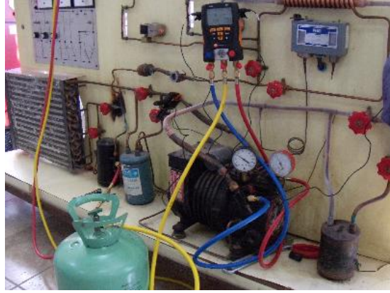
Resim 1.11: Dijital servis manifoltunun bağlantısı
