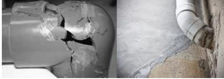
Resim2.6:Döşeme esnasında oluşabilecek deformasyon
