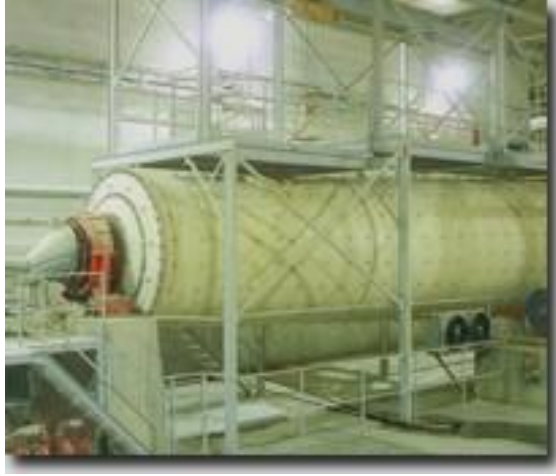
Resim 3.2: SPY – DRAYER Sulu karışımın silolara dökülmesini sağlayan ünite
