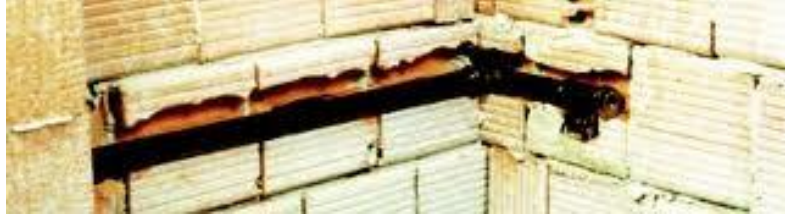
Resim1.4: Paslanmış tesisat borusu
