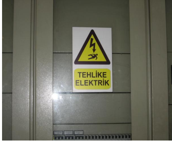
➤ Elektrik tehlikesi levhası
