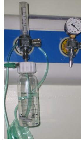
Resim 1.3: Merkezi sistem oksijen kaynağı
