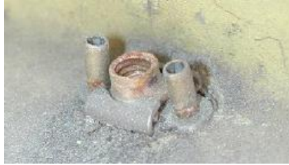
Resim 1.2: Uçak üzerinde galvanik korozyon
