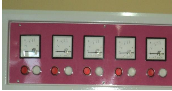
Resim 2.5: Elmas ve keçe motor çalıştırma panosu
