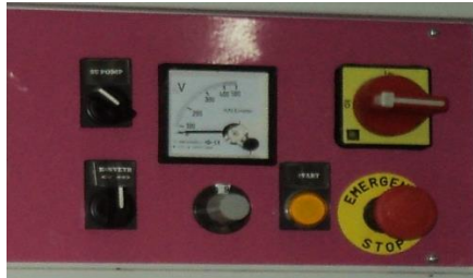
Resim 2.2: Kanal açma makinesi kontrol paneli
