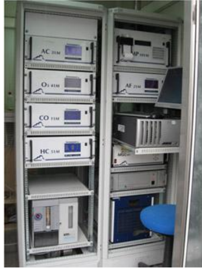
Resim 3.4: Hava kalitesi ölçüm istasyonu iç görünüm
