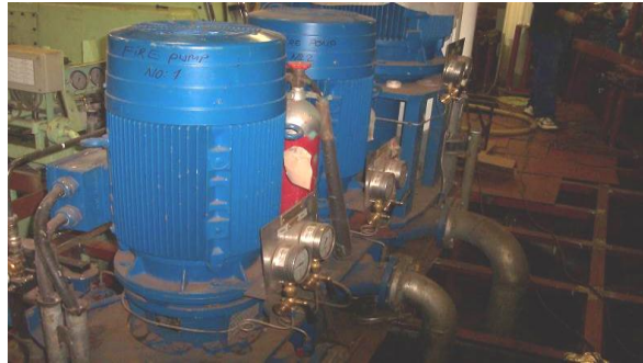
Resim 2.3: Normal yangın pompası
