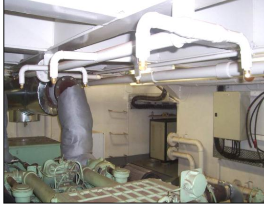
Resim 2.7: Makine dairesi yangın bağlantısı
