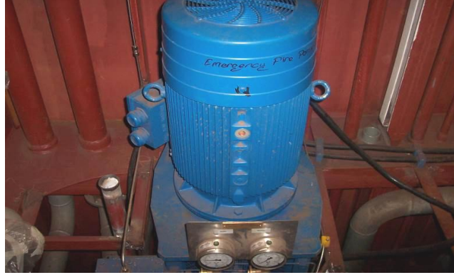
Resim 2.4: Acil durum pompası
