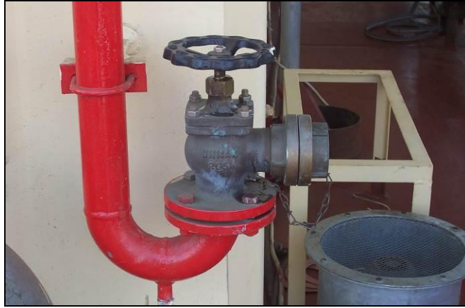
Resim 2.1: Yangın tesisatı valf bağlantısı
