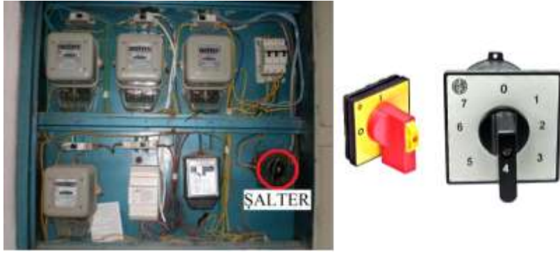
Resim 2.17: Elektrik panosu ve elektrik şalteri
