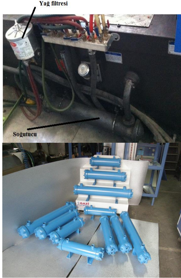
Resim 3.11: Yağ soğutma sistemi
