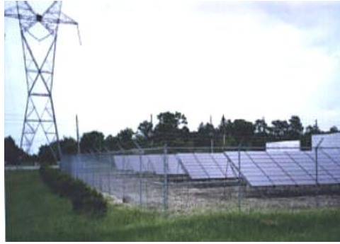
Resim 4.1: Işık Enerjisi ile elektrik enerjisi elde eden foto-voltaik sistem
