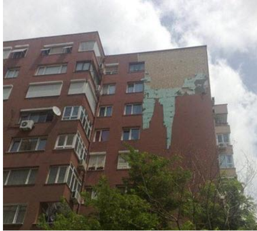
Resim 3.2: Mantolama hatası sonucu sıva dökülmesi
