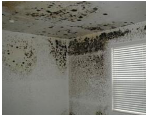
Resim 4.1: Duvar ve tavanda küf oluşumu
