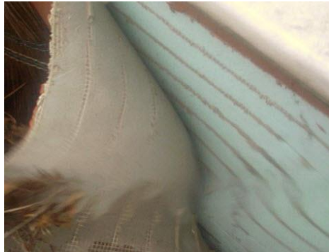
Resim 3.3: Sıvanın izolasyon levhasından ayrılması
