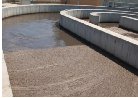
Resim 1.2: Aerobik çürük çamur
