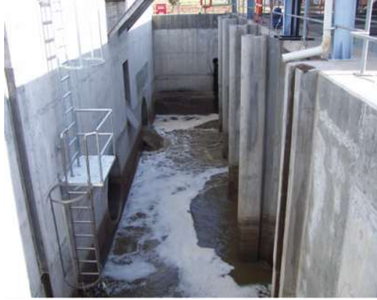
Resim 2.2: Fiziksel arıtım tesisi giriş pompa ünitesi su iletim ünitesi
