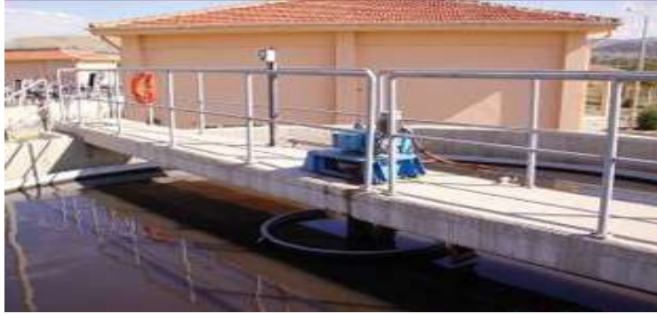
Resim 2.13: Çamur koyulaştırma ünitesi
