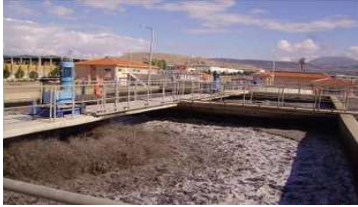
Resim 2.12: Biyolojik arıtma havalandırma havuzu
