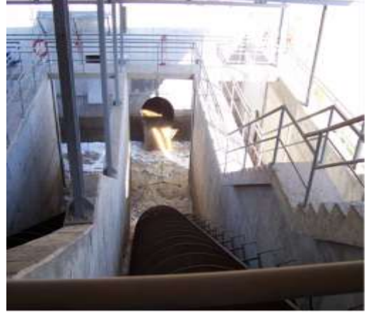
Resim 2.3: Ana kolektör atık su iletim ünitesi
