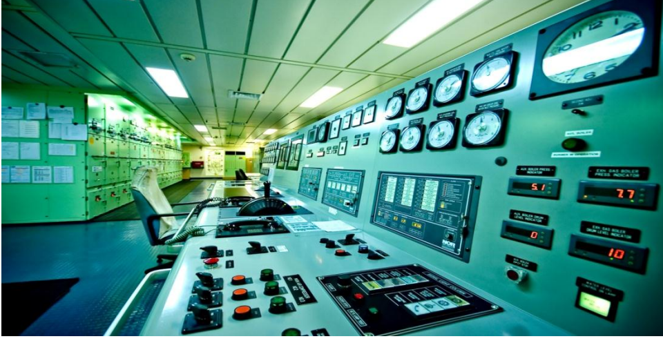
Resim 2.1: Makine kontrol odası
